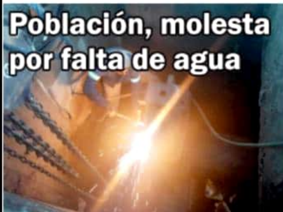
CD. LÁZARO CÁRDENAS, MICH.- Hasta entrada la noche de ayer se seguía trabajando en la instalación de una válvula en el acueducto industrial, que dejó sin agua a la ciudad desde el pasado viernes 30 de noviembre.
