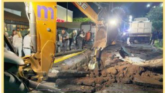
MORELIA, MICH.- Tras abrirse un socavón en la lateral de avenida Camelinas durante la lluvia de ayer Obras Públicas municipal realizará un peritaje para determinar las causas del daño en la carpeta asfáltica.
