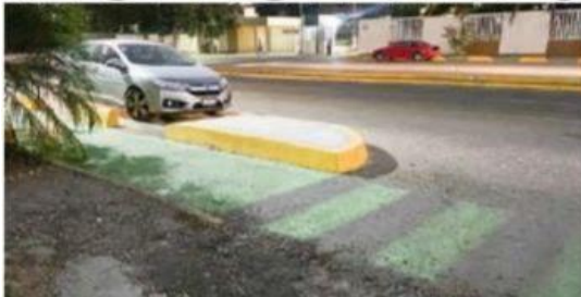
Además de las molestias que causan los mega topes, esta estructura de cemento colocada en cada esquina, como parte de la ciclovia, ha provocado ya varios accidentes vehiculares. (Foto: Kike Rivera).
