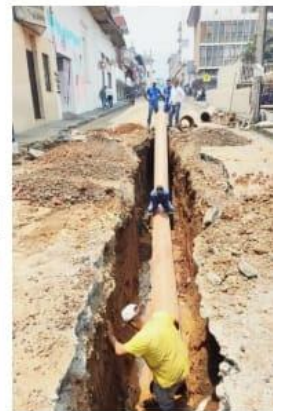
URUAPAN, MICH.- La Capasu reparó un socavón provocado por una fuga de agua potable, en la calle 5 de Febrero en la zona centro de esta ciudad.
