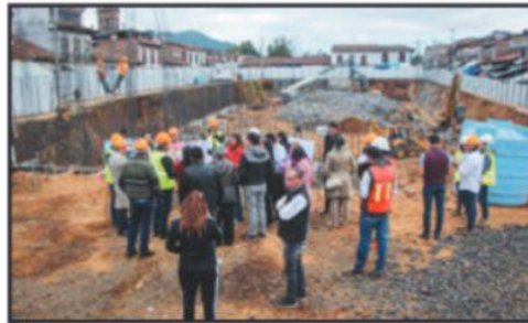
GLADYS BUTANDA Y DIPUTADOS REALIZARON UN RECORRIDO POR LA OBRA EN DONDE YA ESTÁ CONCLUIDA LA EXCAVACIÓN DEL SÓTANO.
