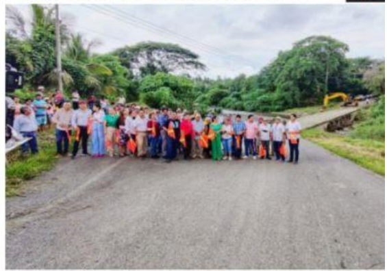
CD. LÁZARO CÁRDENAS, MICH.- Este lunes, habitantes de El Bordonal, compañía de la presidenta Itzé Camacho, dieron inicio a los trabajos de construcción del puente vehicular de la comunidad.
