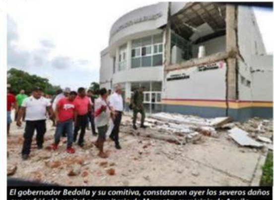
El gobernador Bedolla y su comitiva, constataron ayer los severos daños que sufrió el hospital comunitario de Maruata, municipio de Aquila.
