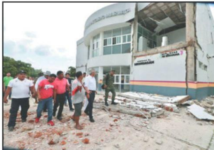
El Hospital Comunitario de Maruata, en el municipio de Aquila, resintió severos daños. El gobernador Alfredo Ramírez Bedolla recorrió la zona de desastre para evaluar la magnitud de las afectaciones.
