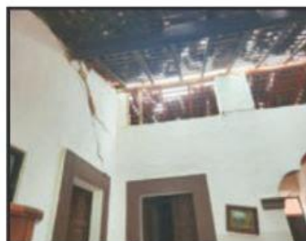
En la región Sierra-Costa, principalmente en Coahuacán y Aquila, cientos de viviendas fueron dañadas.
