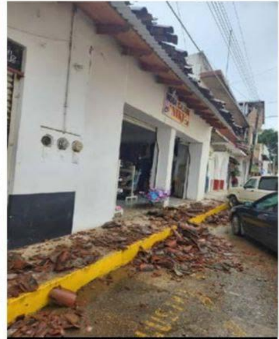
Uno de los daños visibles en viviendas de Coalcomán, tras el fuerte sismo de ayer.
