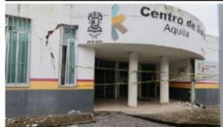
Por indicaciones del Ejecutivo Estatal, este Centro de Salud de Aquila, será sometido a revisión, tras el sismo del lunes. Actualmente se encuentra cerrado.
