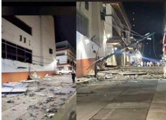
URUAPAN, MICH.- Poco después de la 1 de la madrugada un nuevo sismo de 5.5 grados, nuevamente con epicentro en Coalcomán, despertó a gran parte de la población; los primeros reportes son de daños en la estructura del edificio ubicado en Emilio Carranza y 20 de Noviembre, en el centro de esta ciudad.
