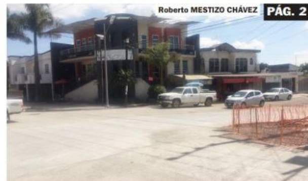
URUAPAN, MICH.- Un 85% de avance presentan los trabajos de modernización que se realizan en la calle Lateral Sur del Boulevard Industrial, donde por la eficiencia de la labor de la empresa Cempro, este sábado se reabrió a la circulación vehicular la calle Costa Rica, que estuvo cerrada dos semanas.
