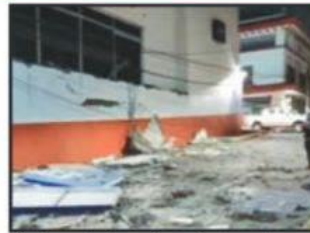
El sismo de la madrugada de este jueves dejó severos daños en edificios de Uruapan.
