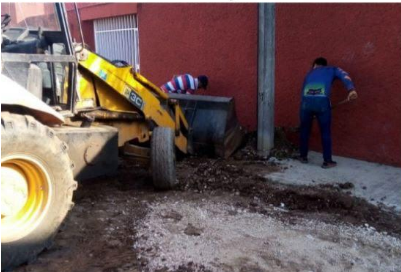
CD. LÁZARO CÁRDENAS, MICH.- La red de aguas negras del Primer Sector desde años acabó obsoleta, por lo que urge su rehabilitación.
