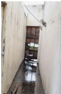
CD. LAZARO CÁRDENAS, MICH.- Los daños en las oficinas que albergan a las dependencias estatales en esta ciudad y puerto, son evidentes.
