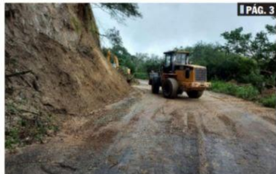
COALCOMÁN, MICH.- Por medio de Apoyo Parcial Inmediato del gobierno federal, se aportarán recursos para la reparación prioritaria y urgente de ocho caminos carreteros afectados por el sismo de septiembre pasado. Informó el secretario de Comunicaciones y Obras Públicas, José Zavala Nolasco.
