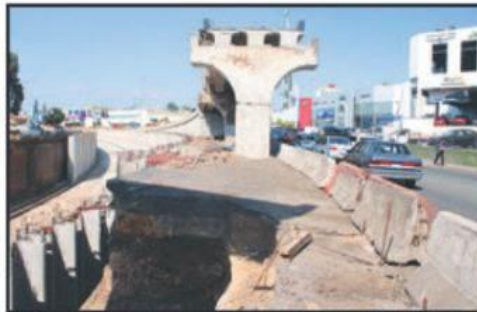
HAN TRANSCURRIDO 2 AÑOS DESDE QUE SE INICIARON LAS OBRAS DE LOS DISTRIBUIDORES Y AÚN NO HAY PARA CUÁNDO.
