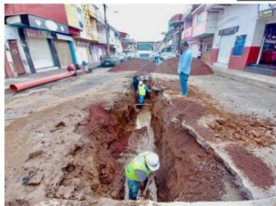
URUAPAN, MICH.- Un socavón se formó en la avenida Francisco Villa ca...
