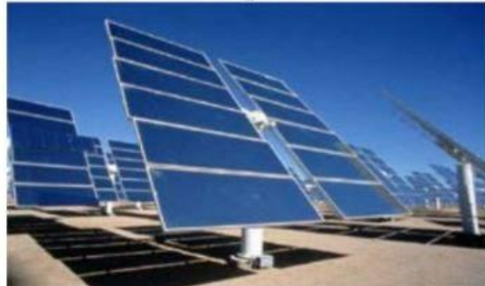
Con una inversión de 20.4 millones de pesos, la ASIPONA planea instalar 610 paneles solares para la generación de energía fotovoltaica para iluminar las vialidades del Recinto Portuario.
