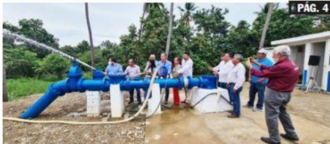
D. LÁZARO CÁRDENAS, MICH.- Este viernes autoridades federales, estatales y municipales inauguraron la nueva línea de conducción del pozo profundo que abastecerá a los habitantes de la tenencia La Mira y la comunidad de Acalpican de Morelos.
