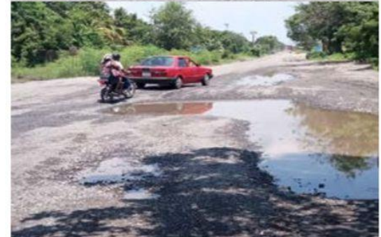
Enormes baches o incluso pérdida total del pavimento, así se observa en una buena parte del libramiento carretero de la ciudad, con el consecuente riesgo de accidentes y daños mecánicos a los vehículos que transitan por ahí.
