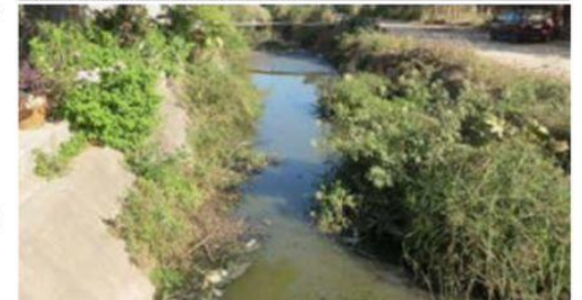
La proliferación de aguas residuales "a cielo abierto", es un riesgo latente a la salud pública de diversas colonias del municipio, sin que ninguna autoridad hasta el momento haga algo por remediar esta situación.
