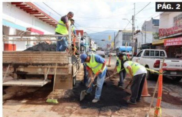
URUAPAN, MICH.- La Capasu reparó en tiempo récord la avería registrada en la avenida Francisco Villa casi esquina con Álvaro Obregón.
