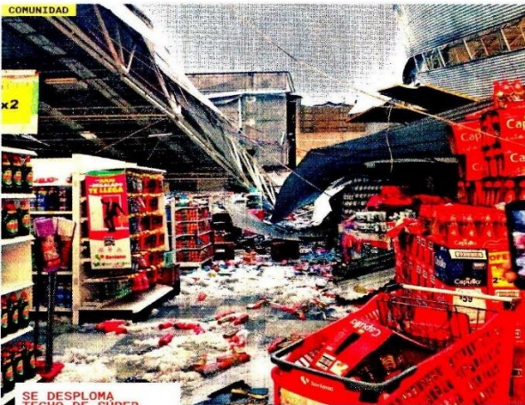
COMUNIDAD SE DESPLOMA TECHO DE SÚPER
