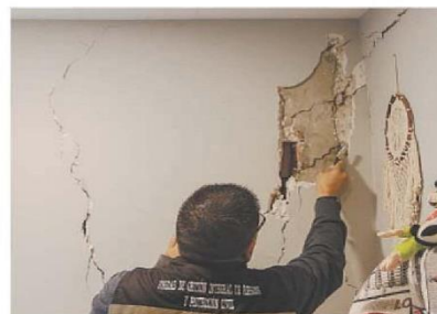
Personal de Protección Civil revisa los daños por los microsismos en el conjunto habitacional Los Patios, en Mixcoac.
