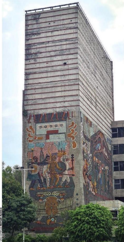
EL MURAL Los Aztecas tiene desprendimiento de teselas que se suman a las antes desmontadas.
