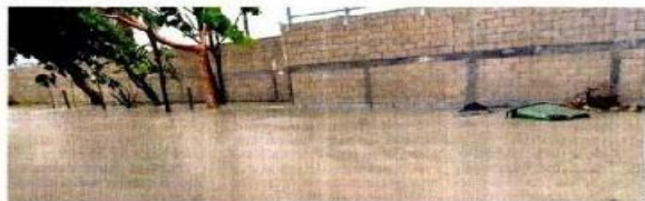
Vecinos aseguran que al terreno aplastado, los nuevos caminos y la barda perimetral de la refinería, han bloqueado al paso del agua de lluvia y su absorción en los manglares.
