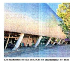
Las fachadas de las escuelas se encuentran en mal estado, debido a la falta de mantenimiento.
