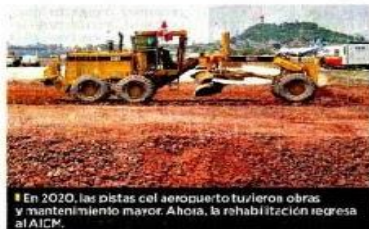
En 2020, las pistas del aeropuerto tuvieron obras y mantenimiento mayor. Ahora, la rehabilitación regresa al AICM.
