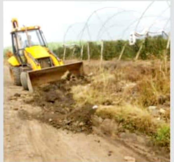
TOCUMBO, MICH.- Continúan los trabajos de rehabilitación de caminos "sacacosecha" en diferentes puntos del municipio.
