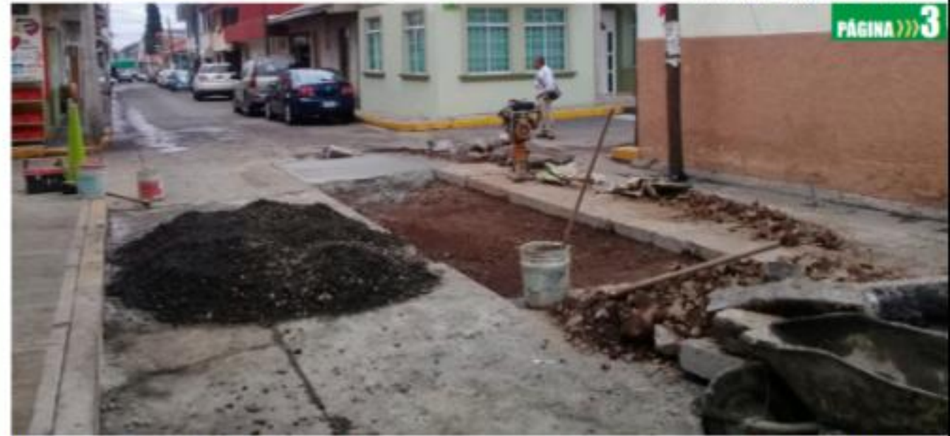
URUAPAN, MICH.- Con las primeras lluvias de la temporada se presentaron también hundimientos y socavones, que de inmediato atiende la Capasu.
