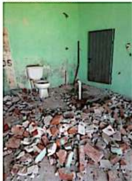
LOS REYES, MICH.- Condiciones en que quedó el vestidor para árbitros de la cancha Eréndira.
