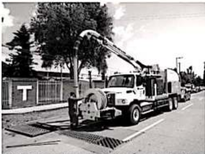
URUAPAN, MICH.- El titular de la dependencia también detalló que han sido atendidos casi todos los 149 reportes de fugas, así como el desazolve de drenajes y colectores, así como los reportes por falta de agua o tomas tapadas
