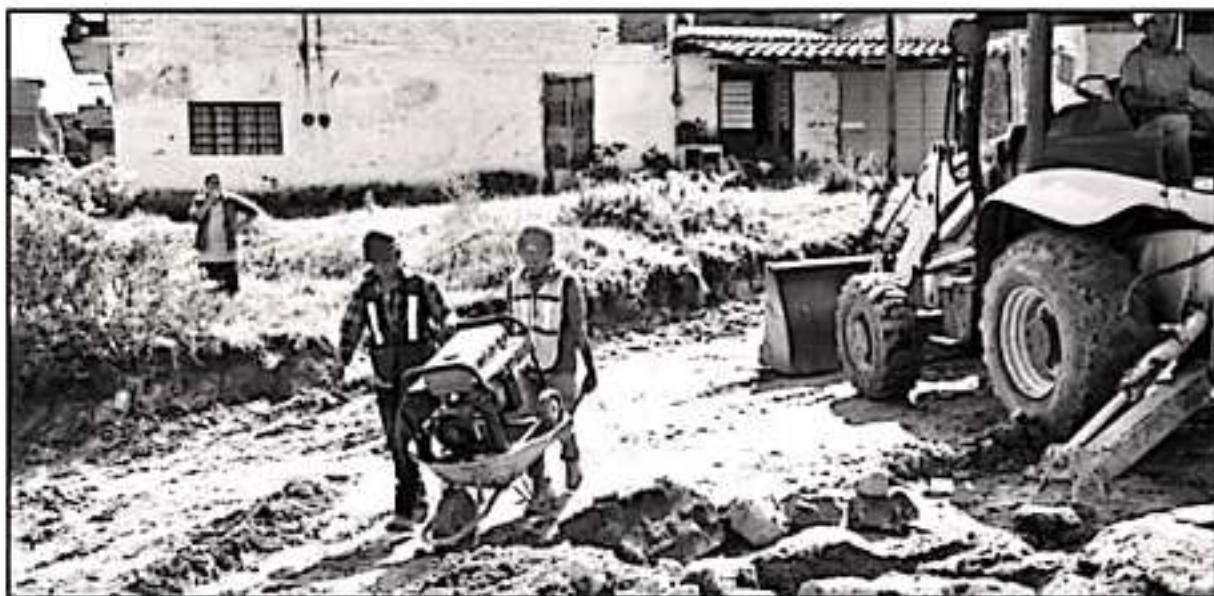
FINALMENTE SE DIÓ EL ARRANQUE DE LAS OBRAS CON LOS 300 MILLONES DE PESOS QUE HABÍAN SIDO PROMETIDOS DESDE HACE CASI UN AÑO
