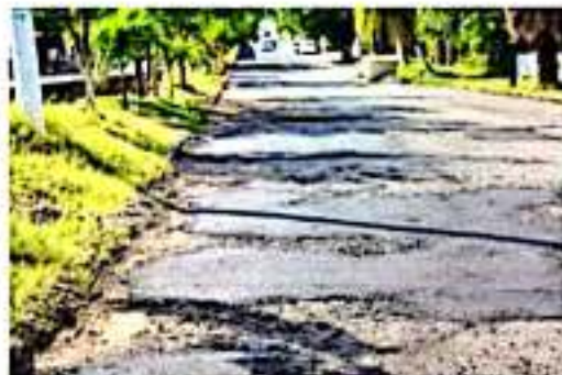
CD. LÁZARO CÁRDENAS, MICH.- Se han bacheado un promedio de 5 kilómetros en diferentes vialidades, informó la Secretaría de Obras Públicas Municipales.
