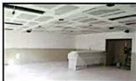
INSTALAN SERVICIO DIGITAL EN EL HOSPITAL DE CAMÉLINAS.
