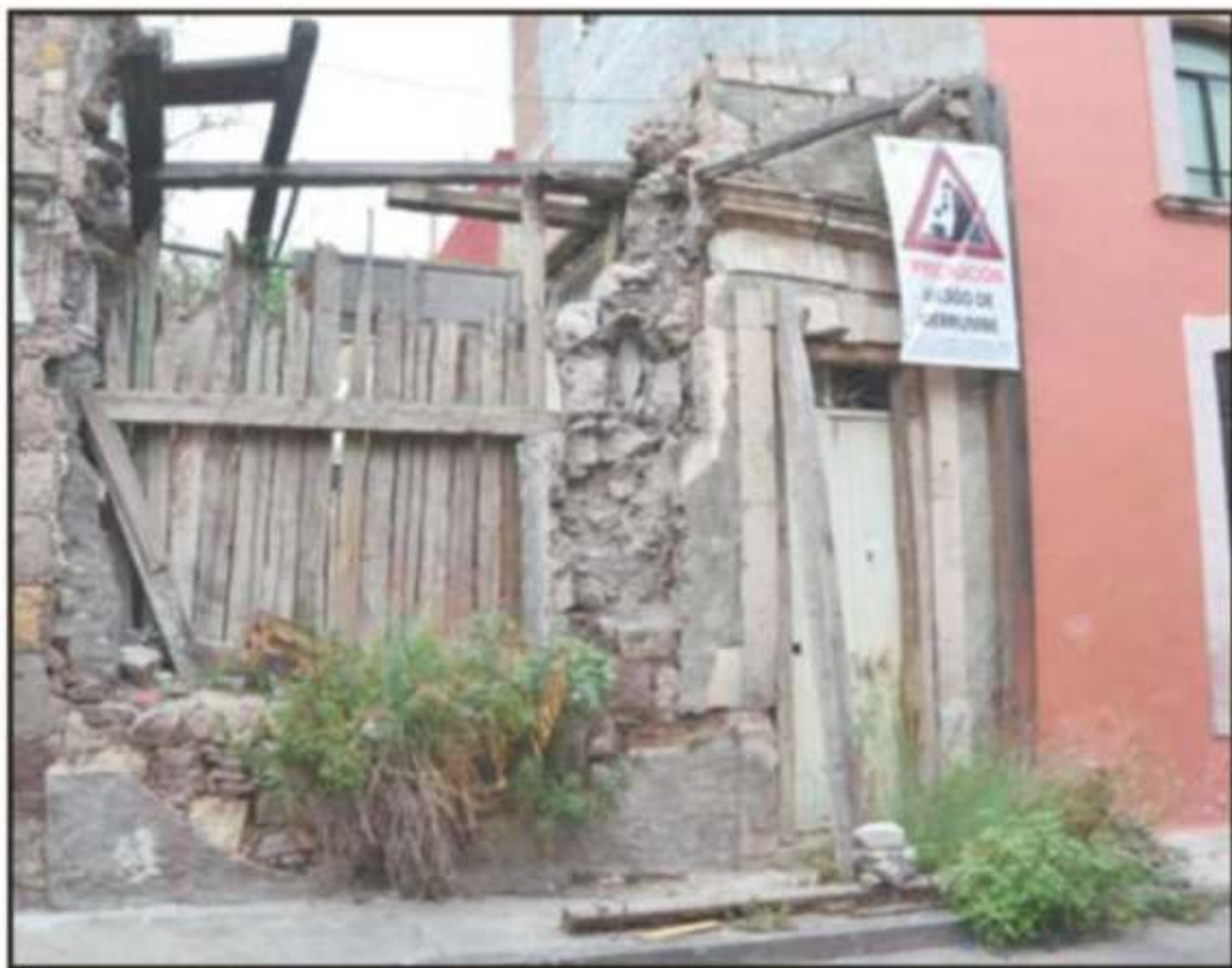
EN EL CENTRO DE MORELIA SE COLOCÓ SEÑALÉTICA EN 15 INMUEBLES CON RIESGO DE QUE SU FACHADA SE VENGA ABAJO.
