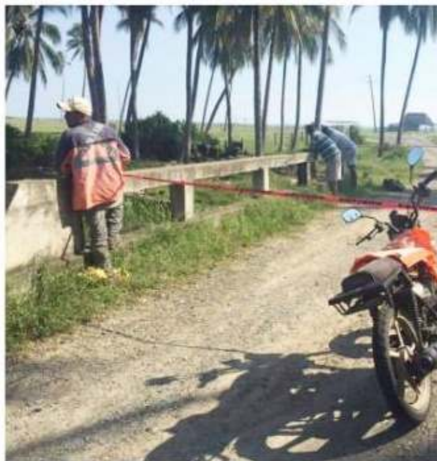
CD. LÁZARO CÁRDENAS, MICH.- PCM, avaló el cierre del paso de la comunidad y El Habillal, debido a un peligroso socavón que se formó durante las lluvias.
