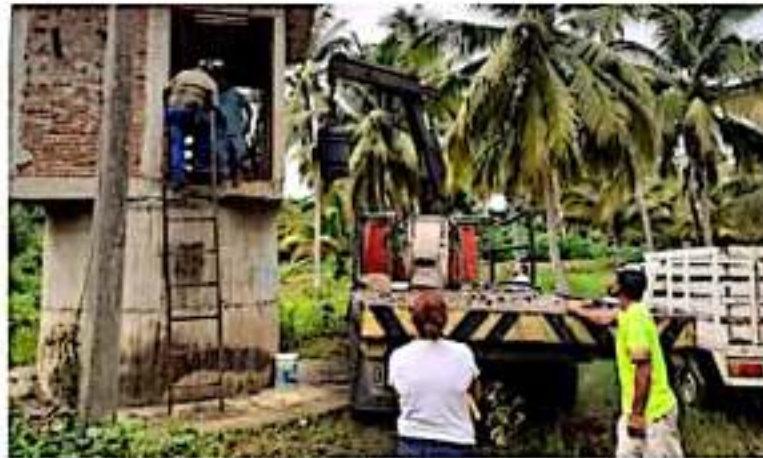
CD. LÁZARO CÁRDENAS, MICH.- Luego de la descompostura que sufrió la bomba que da funcionamiento al suministro de agua potable en la tenencia El Habillal, se logró reparar y restablecer el servicio el pasado miércoles a más de 200 viviendas.
