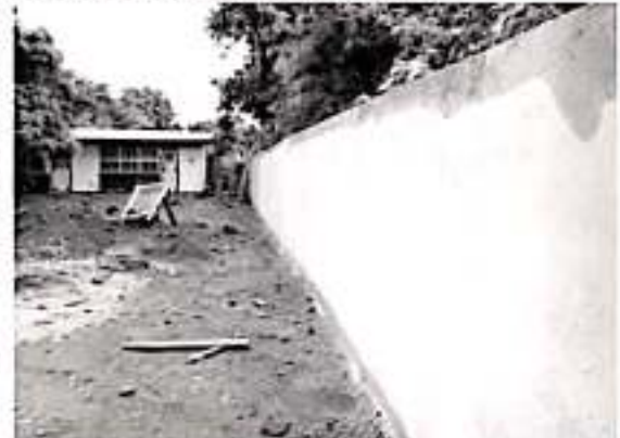
PARACUARO, MICH. El gobierno municipal que preside Huriel Bautista Cabrera construye barda perimetral del Jardín de Niños Sor Juana Inés de la Cruz, obra solicitada por directivos de esta institución.
