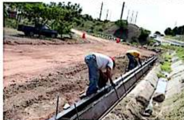
APATZINGÁN, MICH.- Personal de Obras Públicas del municipio pidió la comprensión de la ciudadanía por las molestias que genera la rehabilitación integral de algunas calles, obras que, a futuro, serán de gran beneficio.
