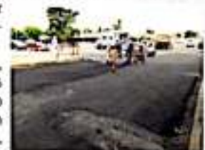
CD. LÁZARO CÁRDENAS, MICH.- La Secretaría de Obras Públicas Municipales mantiene los trabajos del Programa de Bacheo Continuo.
