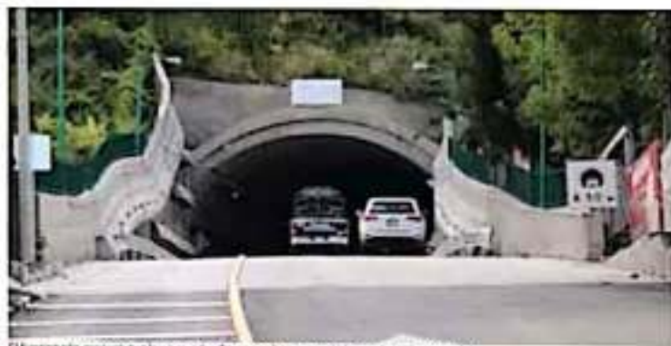
El funcionario aseguró que las pequeñas fisuras no han perjudicado en el túnel. COMTEMA
