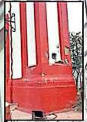
EXTERIOR TAMBIÉN DAÑADO
