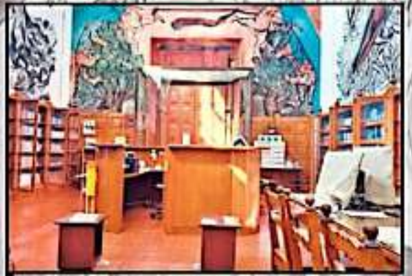
AL FONDO Y LOS COSTADOS SE TIENEN EN TOTAL DE 20 PIZAS DEL CÉLEBRE ARTISTA MEXICANO, LOS CUALES ESTÁN EN JAQUE POR LA HUMEDAD.
