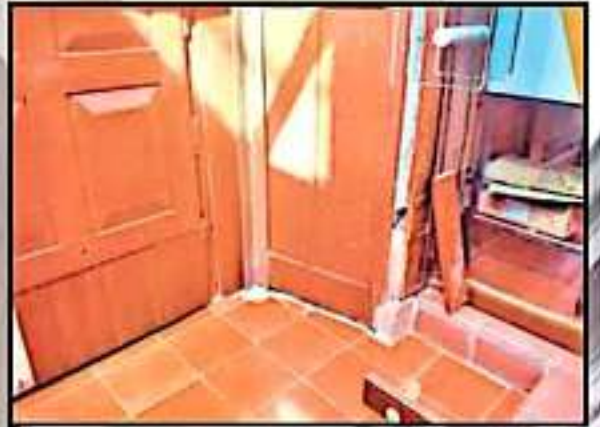
LA HUMEDAD HA DAÑADO TAMBIÉN YA PUERTAS Y PARTES DE MADERA, LO QUE HACE FALTA ES CAPITAL PARA MANTENER LAS REPARACIONES ADECUADAS.
