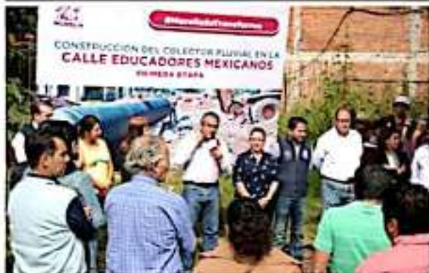
MORELIA, MICH.- Inició la construcción del colector pluvial de la calle Educadores Mexicanos.
