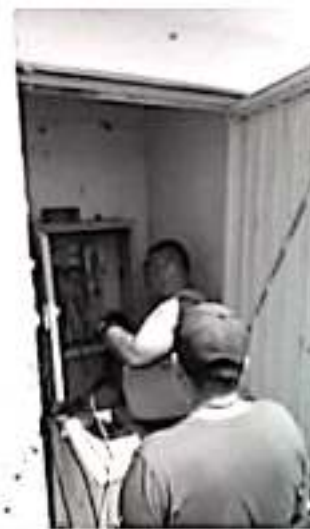
NUEVA ITALIA, MPIO. DE MÚGICA.- Tras varios días de espera, llegó y se instaló el nuevo sistema eléctrico de la bomba de agua del pozo El Panteón, que tuvo un costo de 40 mil pesos y a partir de ayer, la ciudadanía ya cuenta con el servicio del agua potable.
