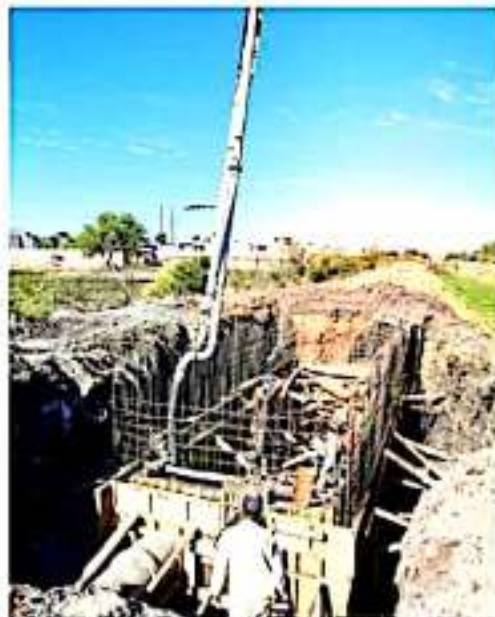
ZAMORA, MICH.- Este proyecto constará de filtros, rejillas de filtración deslizantes para contención de sólidos finos, tren de descarga, etc.
