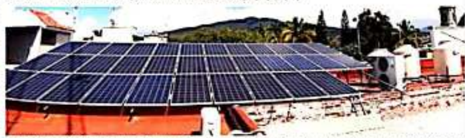
LOS REYES, MICH.- Entró en funcionamiento el sistema de energía solar para abastecer de electricidad al inmueble que ocupa la presidencia municipal.
