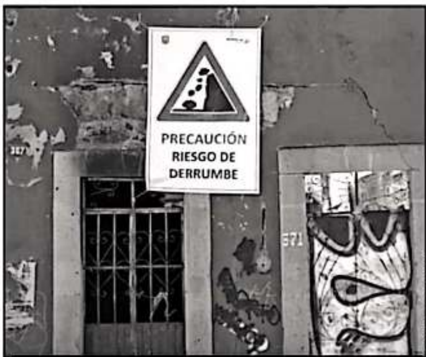
DECENAS DE CASAS DEL CENTRO HISTÓRICO REPRESENTAN RIESGO DE COLAPSO POR LA FALTA DE MANTENIMIENTO
