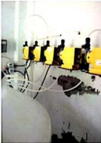
URUAPAN, MICH.- Labores de mantenimiento y limpieza en los equipos de cloración se realizan para garantizar agua potable a la población.
