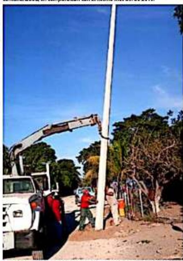
La alcaldesa Itzel Camecha, dio a conocer que continúan los trabajos de electrificación en diversas colonias del municipio.
