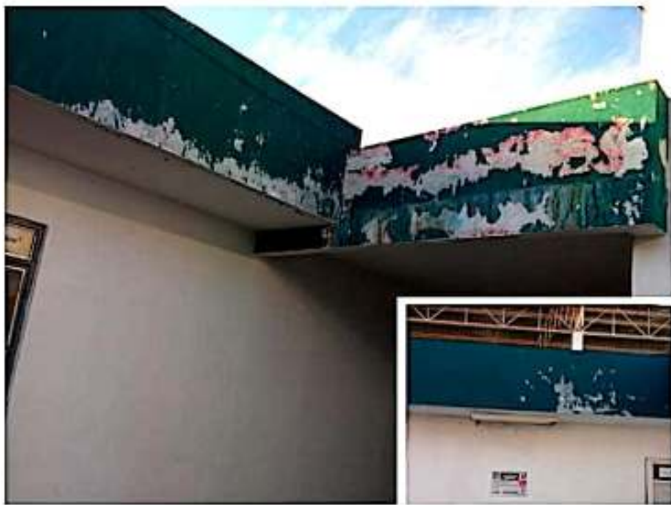
URUAPAN, MICH.- A la falta de trabajos de mantenimiento en techos en el interior, se suma la falta de impermeabilización y pintado de fachadas exteriores, que previamente requieren ser resanadas, entre otras necesidades de los Cedeco's.
