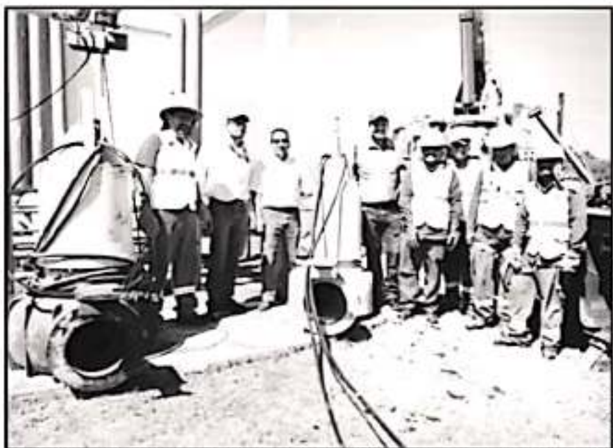
LA CAPASU AUMENTA LA CAPACIDAD DE DESCARGAS EN LA PLANTA TRATADORA DE AGUAS RESIDUALES EN URUAPAN.
