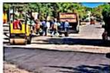
CD. LÁZARO CÁRDENAS, MICH.- Con la finalidad de concluir los trabajos del programa de "Bacheo Continuo" en la Avenida Narciso Bassols, la Secretaría de Obras Públicas Municipal realizó un llamado a la ciudadanía a no tirar agua en las zonas aledañas a la obra.
