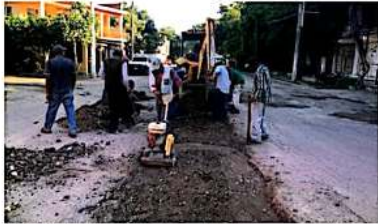
CD. LÁZARO CÁRDENAS, MICH.- Problemas de drenaje sobrepasan capacidad en Las Guacamayas, por lo que se requiere de una urgente intervención quirúrgica, señala el jefe de esta tenencia.
