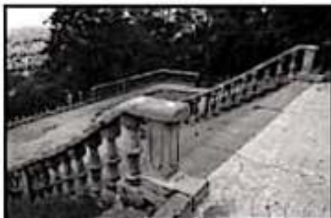
EL SITIO LUCE ABANDONADO Y CON DAÑOS EVIDENTES. CIUDADANÍA EXIGE VIGILANCIA PARA EVITAR LA DESTRUCCIÓN TOTAL.
