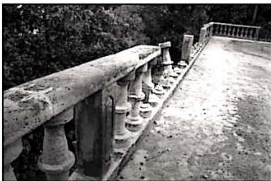
EL BARANDAL DE CANTERA DONDE LA CIUDADANÍA SE APOYABA PARA ADMIRAR MORELIA TAMBIÉN FUE SEMIDESTRUIDO.
