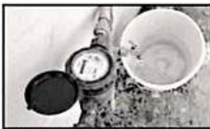
TOMAS CLANDESTINAS DAÑAN INGRESOS DEL OOAPAS
