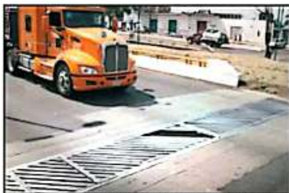
A LA VISTA, REDESINOS Y COLADERAS EN MAL ESTADO Y SIN REPARACIONES.
