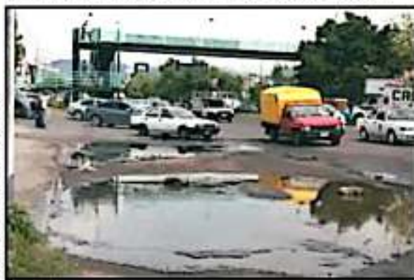
ADÉMÁS DE LOS BACHES, TAMBIÉN HAY HUNDIMIENTOS Y SOCAVONES.
